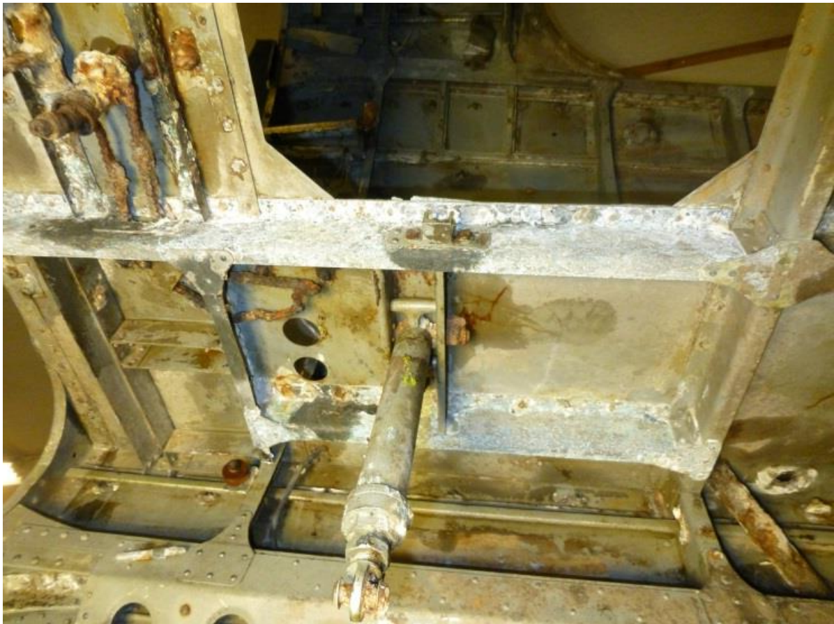
Bilde 11. Plateprofiler i bomberommet med kraftig overflatekorrosjon mens området og platene rundt er i bemerkelsesverdig god tilstand.
